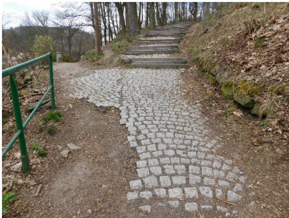
Obr. 38: Kamenné schodiště na počátku křížové cesty vyžaduje nutně rekonstrukci
