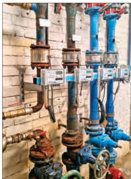
Přívod surové vody do úpravy
